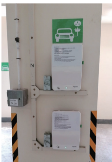
電動車充電設施
